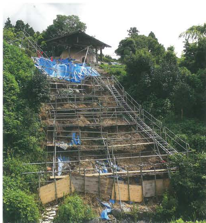
崩落した崖と作業用足場
